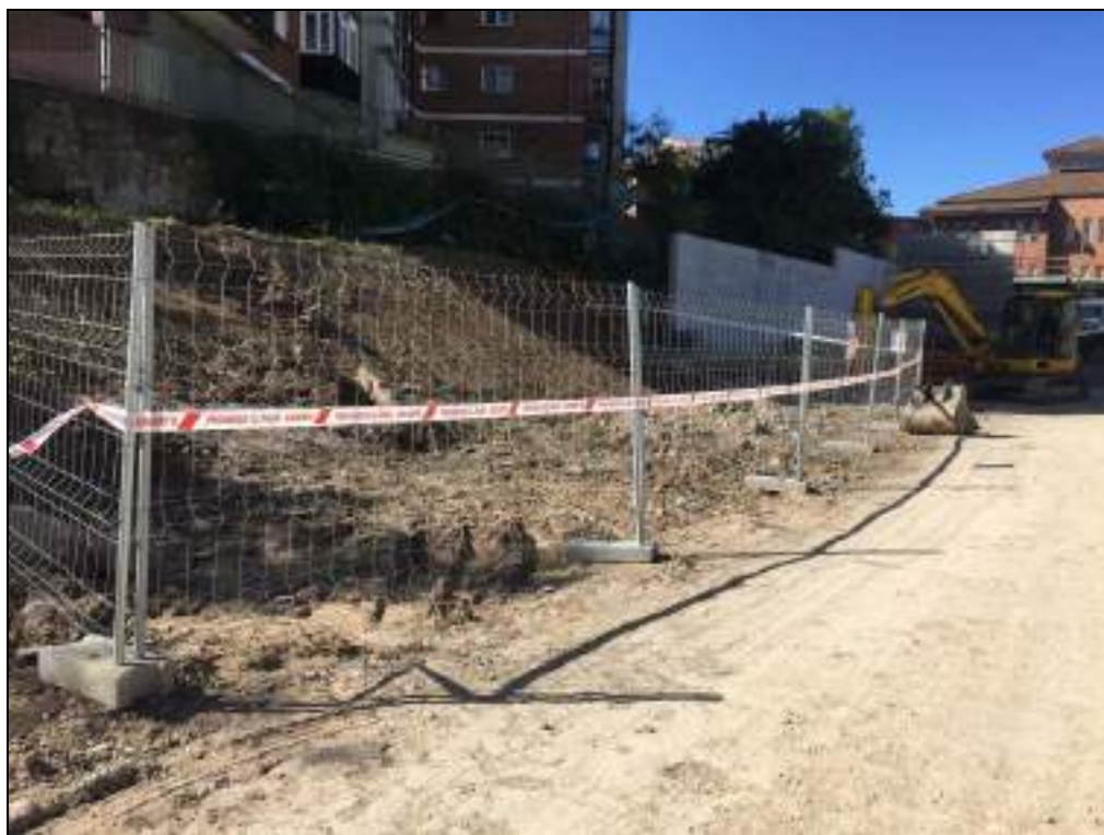
Fotografía 10. Superficie sospechosa de contener rellenos con presencia de amianto (entorno R-1 y R-4) vallada y señalizada
